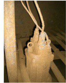
Tauchbelüfter mit Überzug aus abgelagerten Eisenionen im Wasser: Im Gegensatz zu Membranbelüftern wird die Funktion dieser Technologie-Alternative nicht durch einen großen Feststoffanteil im Klärwasser beeinträchtigt (Foto: Tsurumi)
