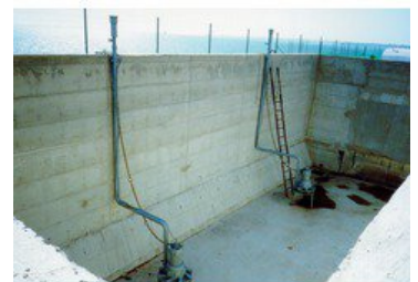
Ähnlich wie in dieser Anlage werden die Tauchbelüfter auch bei Rosvodokanal im Becken betrieben (Foto: Tsurumi)
