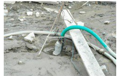
Die beste Pumpe nützt wenig, wenn sie falsch eingesetzt wird. Vorbildlich: Formstabiler Schlauch, Halteseil und zugentlastete Stromzuführung sichern Leistung und Lebensdauer der elektrischer Tauchmotorpumpe (Foto:Tsurumi)
