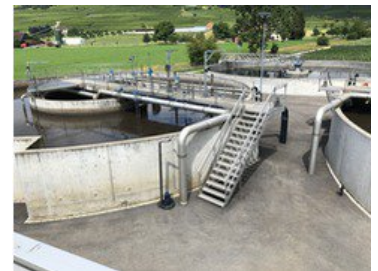
Einer der ausgemusterten Tauchbelüfter samt Zuluftrrohr vor einem der beiden Belüftungsbecken mit 5000 m 3 Volumen (Foto: Tsurumi)
