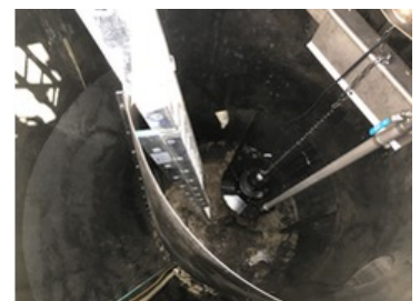
Blick in den Sandfang: Der Tsurumi-Tauchbelüfter ist hängend montiert. In Bild auch Haltekette und Zuluftrrohr mit Absperrhahn (Foto: Tsurumi)
